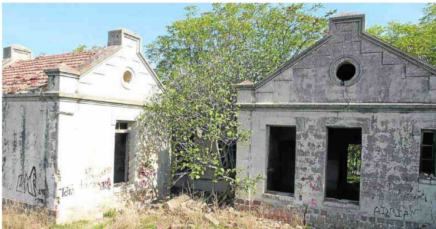
Imagen de archivo, aún sin intervenir en él, del edificio conocido como el Hospitalillo. ENRIQUE
